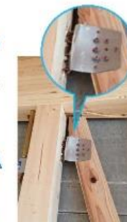
新交い用補強金物ビス抜け
