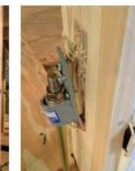
ホールダウン金物損傷
