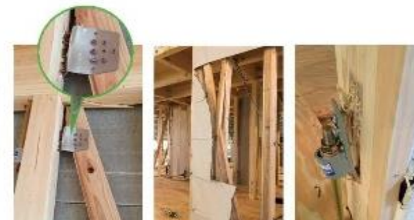
節間・用補強金物ビス抜け 節間・外装損傷 ホールダウン金物損傷
