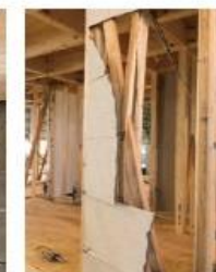
筋交い・外壁損傷
